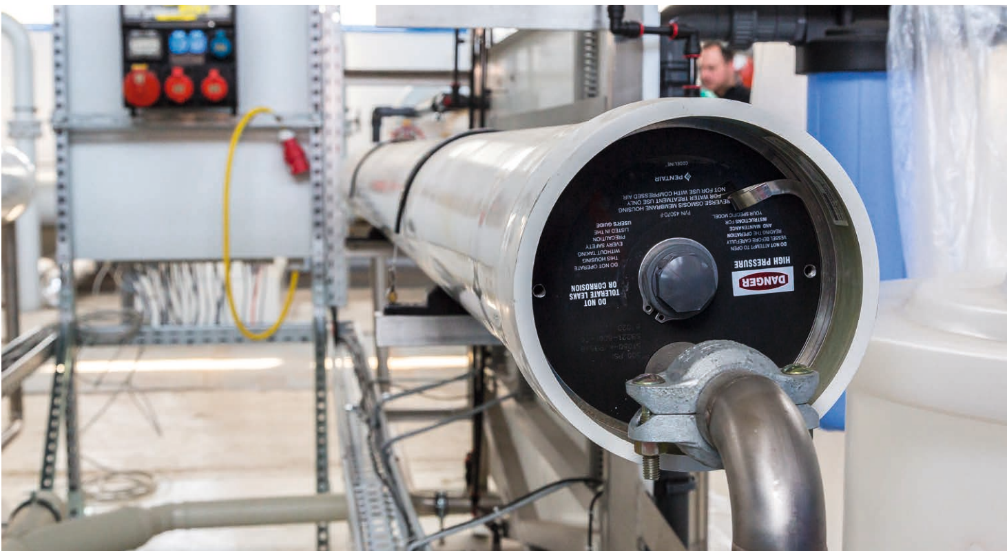
Die Umkehrosmoseanlage als Ersatz für die Vollentsalzungsanlage
