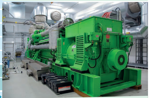
Modul 1 im BHKW
