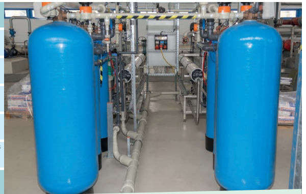
Osmoseanlage in der CWA
