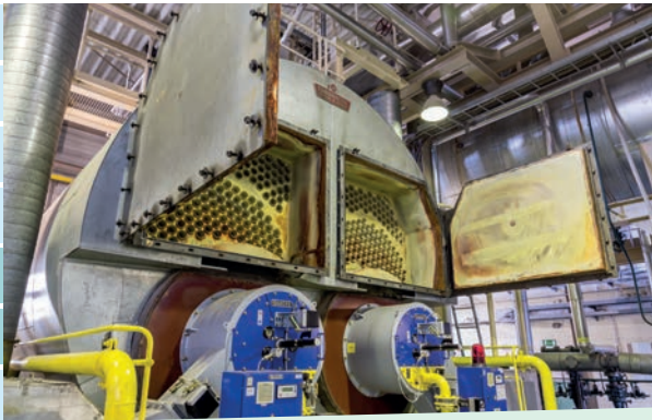
Kessel 11 der Wärmeversorgung
