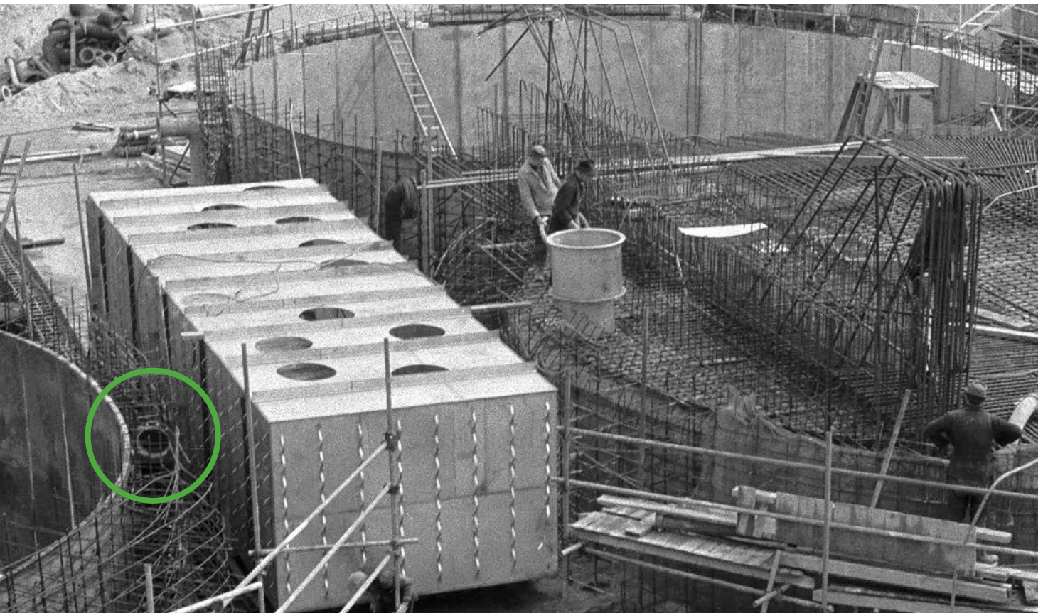
Das ALfR-flüssig im Bau. Der Kreis kennzeichnet die spätere Einbaulage der vier aktuell zu bergenden Sylphonventile.
