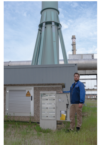
Messtechnik für Stromverbrauch an der Abluftanlage Nord II
