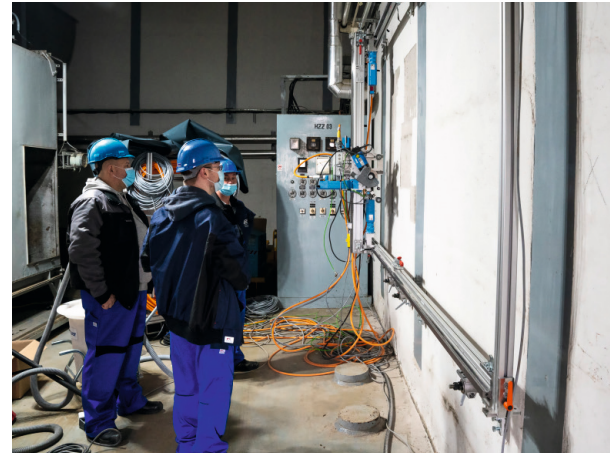
Test der Fräse im E-Raum Block 5
