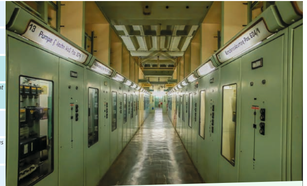
6kV Innenraumschaltanlage im KKR
