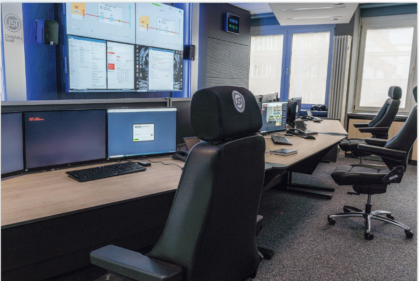
Blick in die neue Zentralwarte
