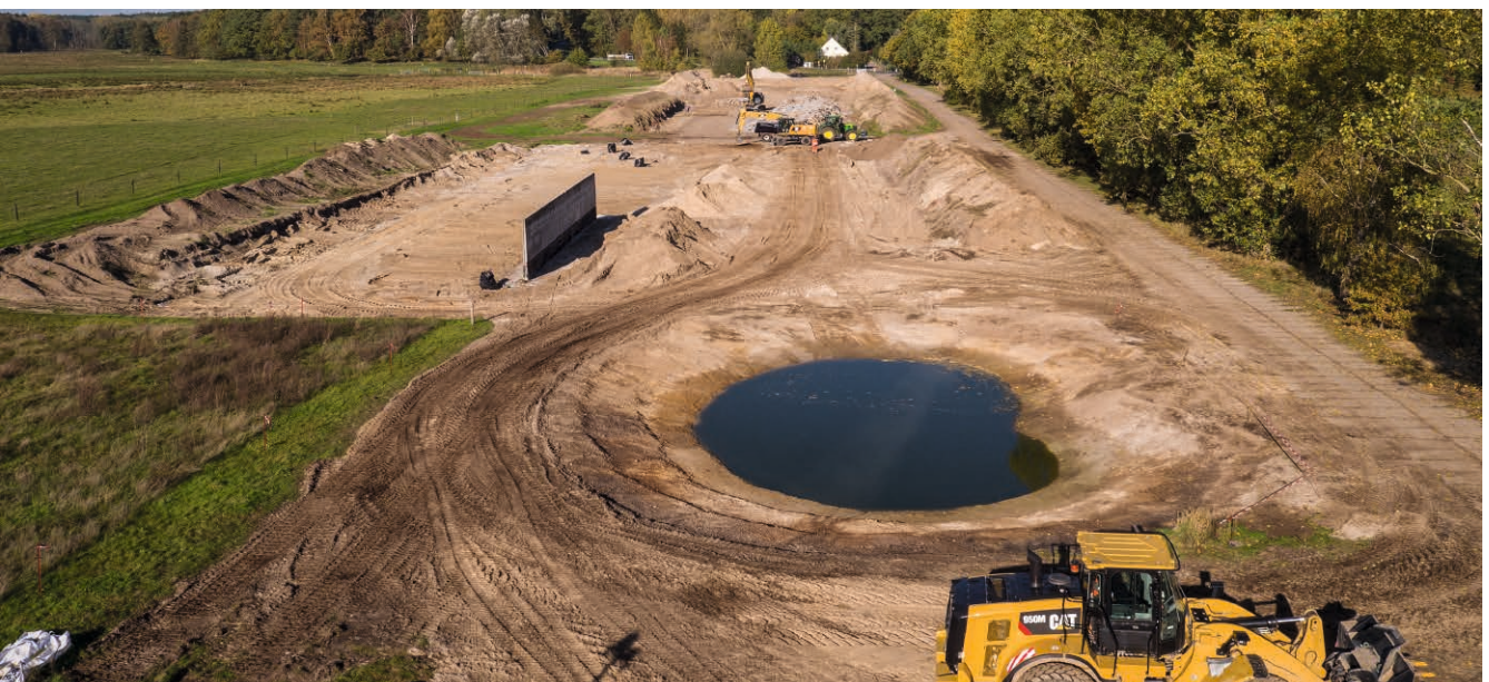
Überblick über die gesamte Baustelle am 29. Oktober. Die Fläche war zu diesem Zeitpunkt bereits weitgehend entsiegelt. Das Kleingewässer und die Brutwand für Uferschwalben waren im Entstehen, doch es galt noch reichlich Erde zu bewegen.
