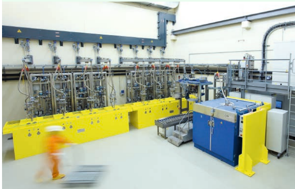
Innenfasstrocknungsanlage und Trockenkammer in der ZDW
