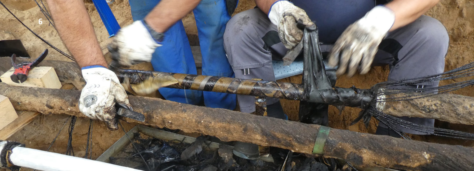
Leckstellen an der 110-kV-Öldruckkabeltrasse
