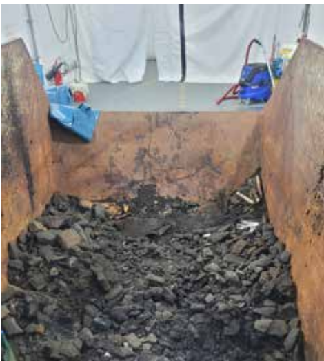
In der Arbeitsstation 8 abgestellte Mulde mit altem Dachmaterial
