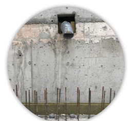
Rohr an Betonwand
