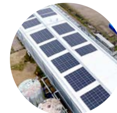
Die Photovoltaik-Anlage auf dem Dach der CWA
