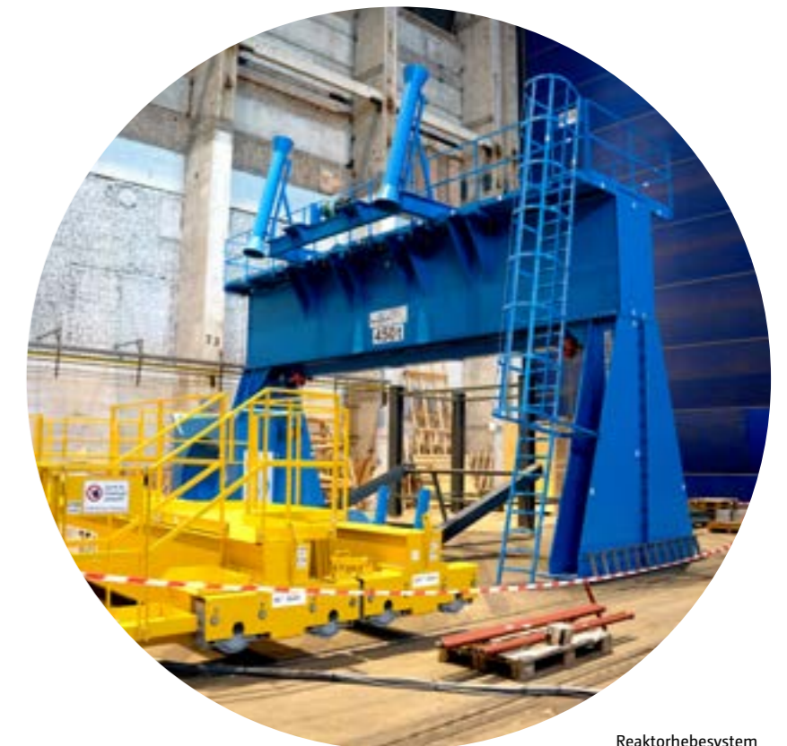
Reaktorhebesystem im Maschinenhaus
