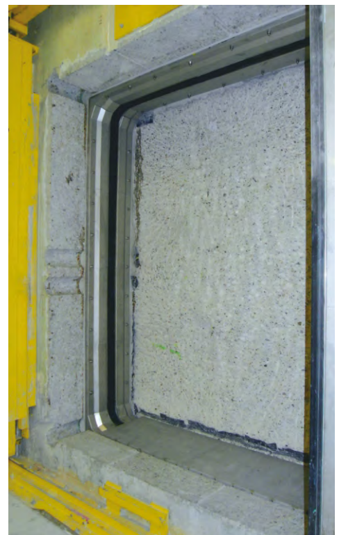
Erdbebensichere Abdichtung: Gebäudefuge zwischen HWL und LAVA.
