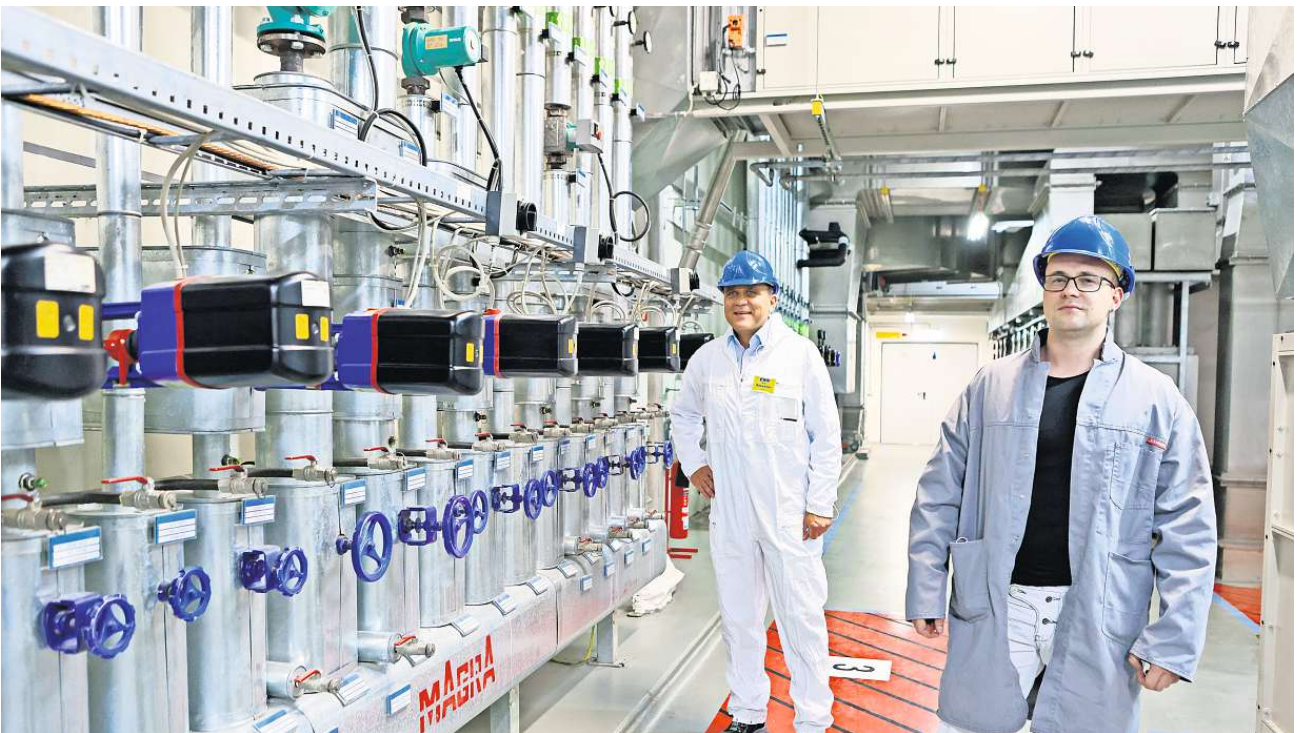
Bild: Jürgen Rosnovsky, Leiter des Fachbereichs für kerntechnische Anlagen der SEAR Gruppe, und EWN-Anlageningenieur Jean Wudtke (r.) stehen vor der nuklearen Lüftungsanlage des Zwischenlagers Nord in Lubmin bei Greifswald.
