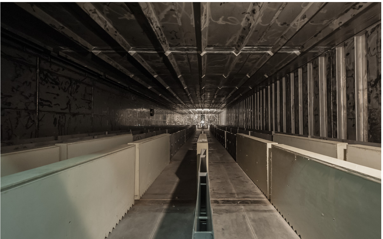
Eine mit Edelstahl ausgekleidete Kondensationskammer.
