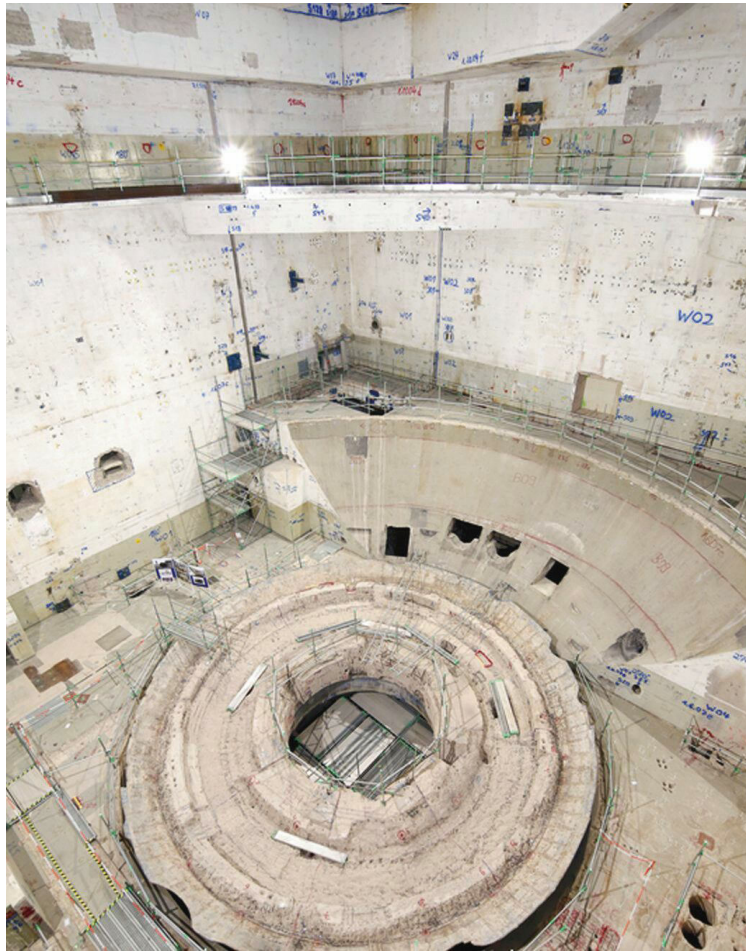
Im Herzen des stillgelegten Kernkraftwerks Würgassen, dessen Rückbau 1997 begann, ist noch die Bodenkalotte des Reaktors zu sehen
