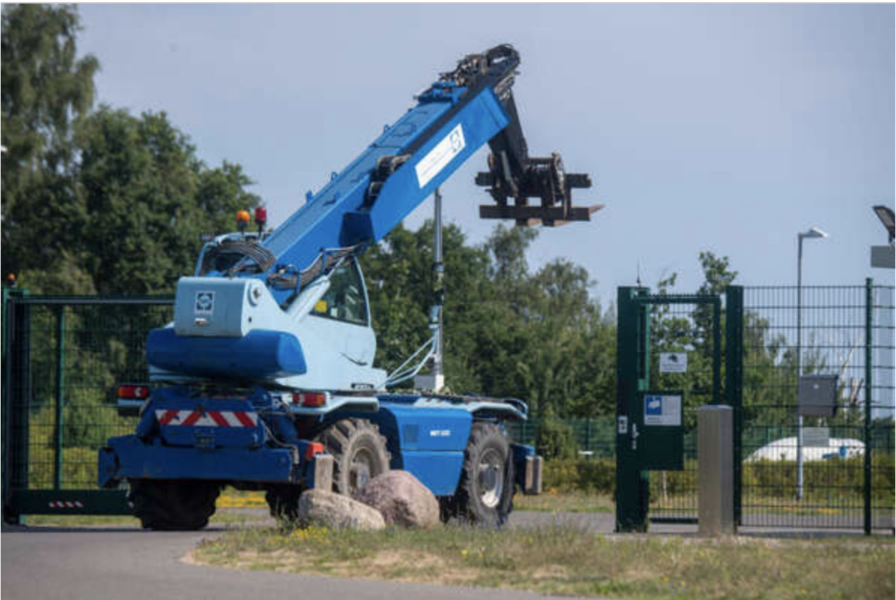
Wartungsarbeiten an der Nord Stream 1: Ein Bagger gestern am stählernen Tor zur Anlandestation in Lubmin.
