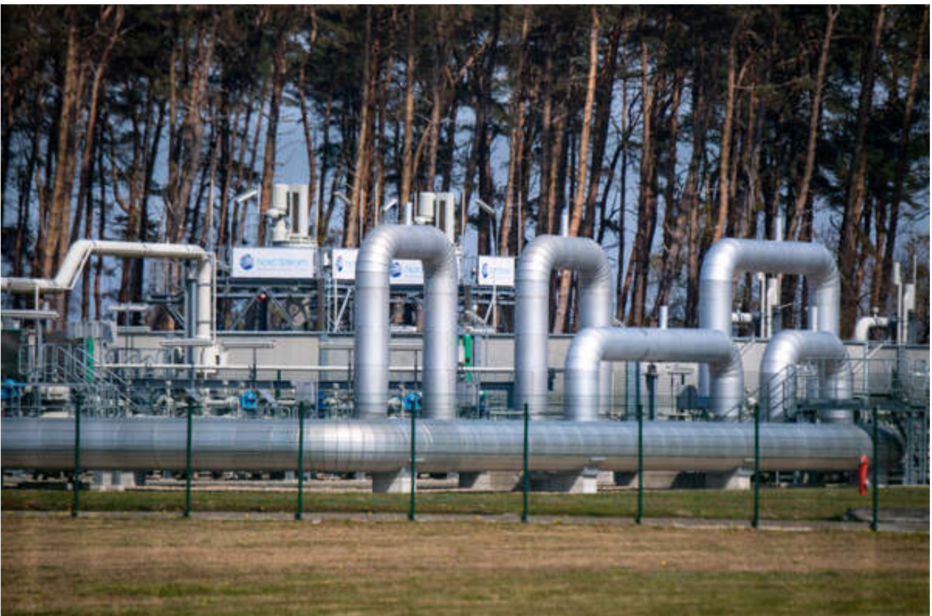
Bild: Seit 2011 kommt hier russisches Erdgas an: Blick auf Absperrvorrichtungen in der Empfangsstation der Ostseepipeline Nord Stream 1 und der Übernahmestation der Ferngasleitung OPAL in Lubmin bei Greifswald.
