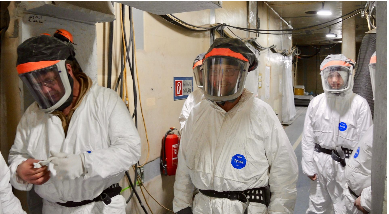
Bildunterschrift: Der Abrisstrupp: Der eine oder andere Mitarbeiter im stillgelegten Atomkraftwerk Greifswald-Lubmin wird im Rentenalter sein, ehe der Rückbau vollendet ist. - Deutschlandradio / Tom Schimmeck
