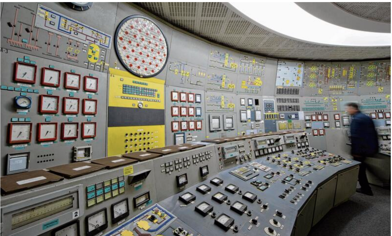
Bildunterschrift: Im Block 6 kann noch immer eine Schaltwarte des stillgelegten KKW besichtigt werden – hier eine Aufnahme aus dem Jahr 2013.
