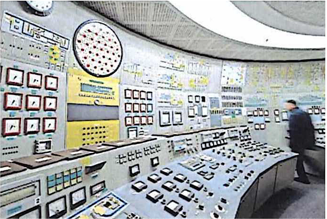
Bildunterschrift: Blick in die Schaltwarte
