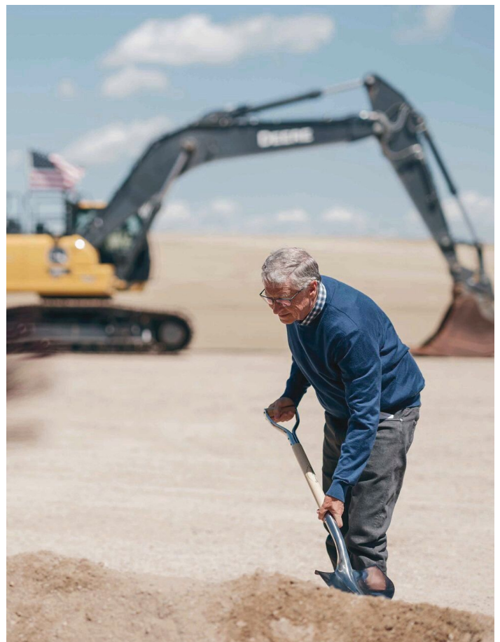
Microsoft-Gründer Bill Gates packt an - beim symbolischen ersten Spatenstich für den Bau eines natriumgekühlten kleinen Kernkraftwerks.
